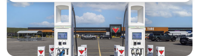
Bornes de recharge pour véhicules électriques dans un magasin Canadian Tire – Welland, Ontario
